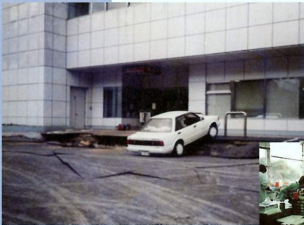
地盤沈下(救急前)
