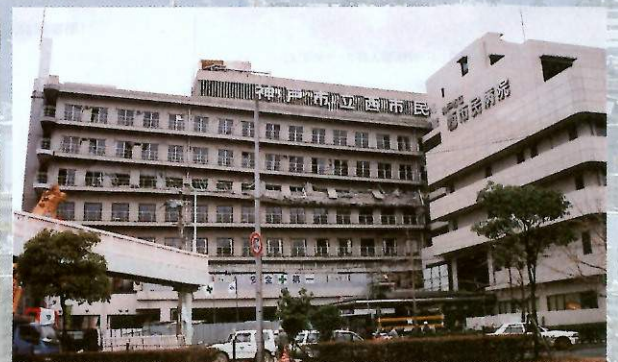
5階部分が押しつぶされるように崩れた西市民病院本館
