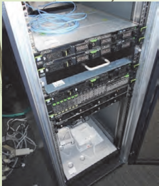
AMEC 計算機サーバ (FUJITSU PRIMERGY)
